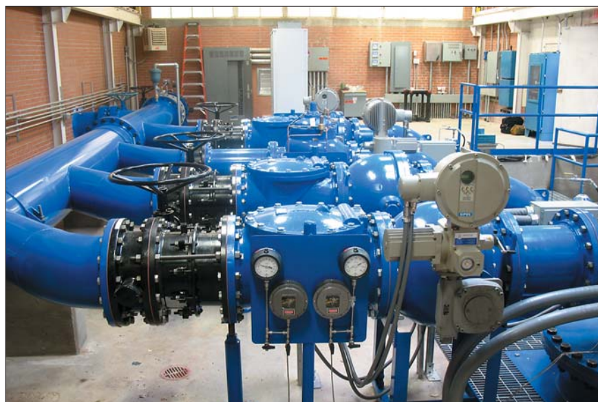
Ilustracja 4. Przepompownia pomp KIVA w gminie Albuquerque. Widoczne są napędy SIPOS 5 służące do sterowania zaworami kulowymi 16". Dzięki liniowej kontroli przepływu napędy gwarantują niezakłóconą eksploatację pomp.
