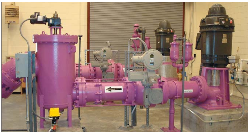
Ilustracja 6. Projekt odzyskiwania wody North Water w gminie Erie jest jedną z najnowszych instalacji, które świadczą o profesjonalnej realizacji projektu przez firmę Pipestone Equipment – również w zakresie inteligentnego zastosowania napędów SIPOS
