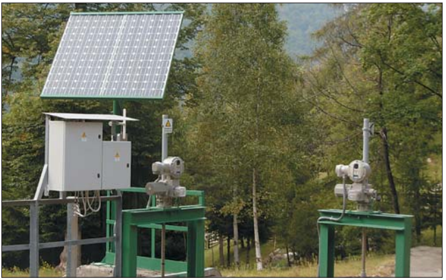
Ilustracja 3. Instalacja fotowoltaiczna firmy SIPOS
