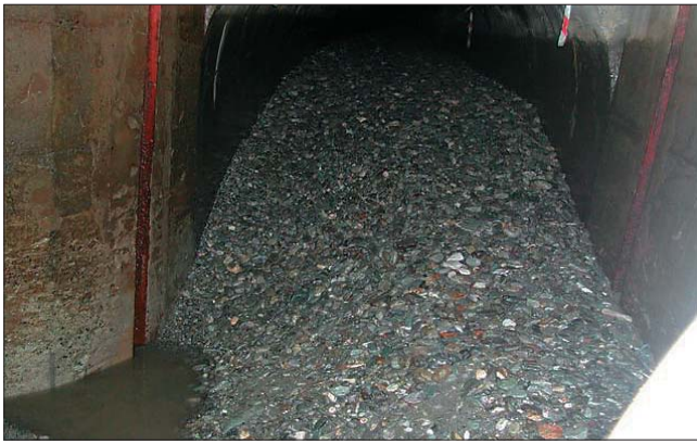
Ilustracja 2. Zatkany wlot wody bezpośrednio w elektrowni
