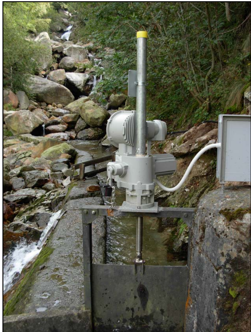
Abb. 1: Typisches Absperwehr mit SIPOS automatisiert
