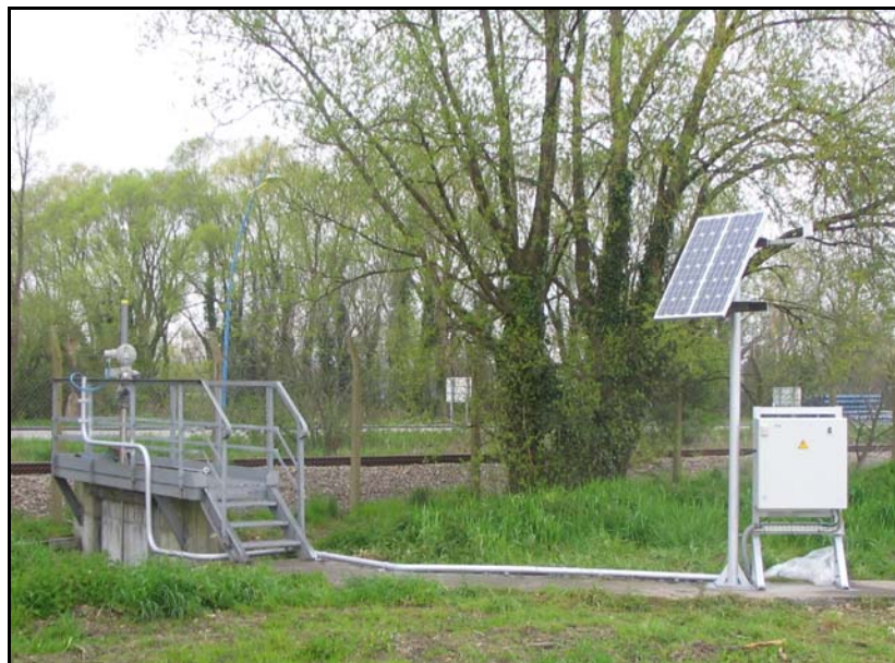
Abb. 4: Wasserlauf automatisiert mit SIPOS Solar
