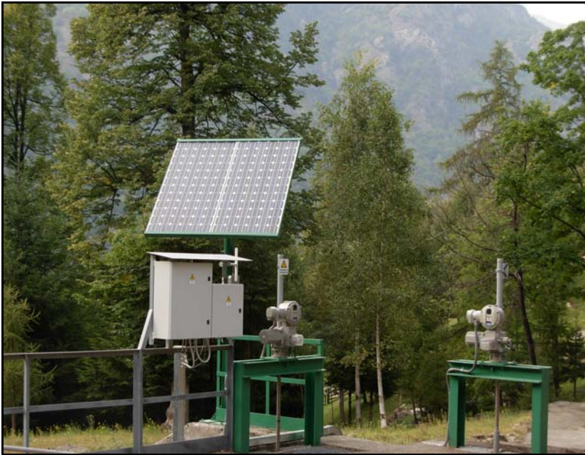
Abb. 3: Fotovoltaikanlage von SIPOS
