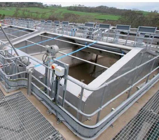
Bild 2: ITT Sanitaires ICEAS SBR integriert SIPOS Stellantriebstechnologie (hier in getrennter Aufstellung) für ein vollautomatisches System, das auf unterschiedliche Zu- oder Abflussraten reagieren kann.
