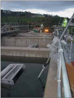
Bild 5: Positionsgenaues Steuern des Dekanterarms mittels adaptivem Stellungsregler: Kläranlage in Charmouth/UK Fig. 5: Spot-positioning control of the decanter arm by means of an adaptive actuator system: Sewage treatment plant in Charmouth, UK
