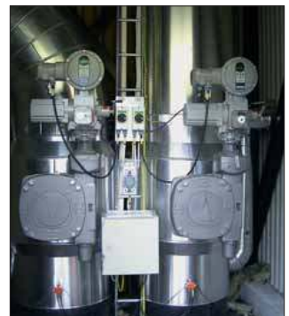
Bild 4: SIPOS 5 Flash in einer Fernwärme-Verteilstation („Fortum district heating“, Upplands Väsby, Schweden)
