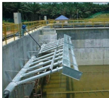
Bild 7: Drehzahlveränderbarer Antrieb an einem Dekanter in einer Kläranlage
