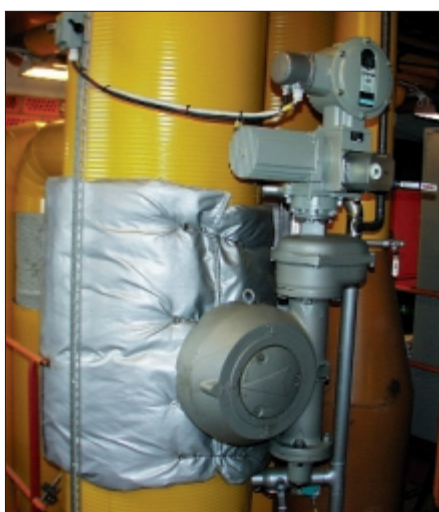
Bild 10: SIPOS 5 Flash in einer Fernwärme-Verteilstation
