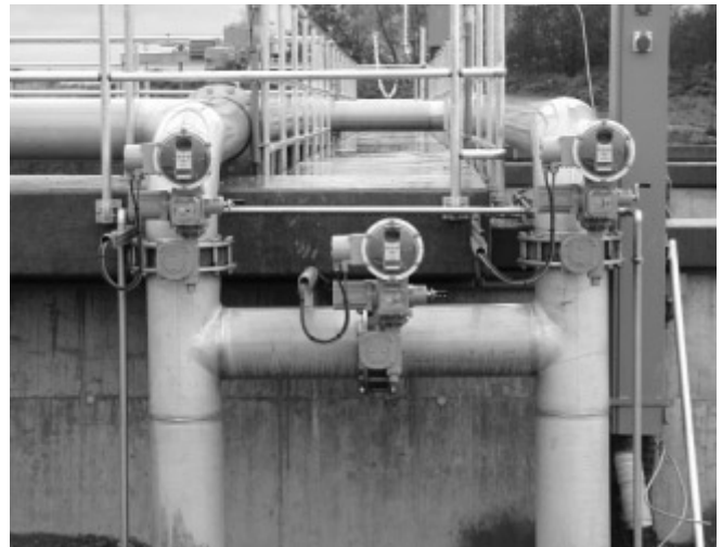
Bild 4. SIPOS Aktorik Stellantriebe – Wind und Wetter ausgesetzt sorgen hier Schwenkantriebe 2SC5 für eine optimale Belüftung.
