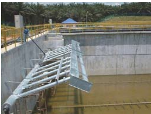
污水处理厂内滗析器上的变速执行器系统 Variable speed actuator system on a decanter in a sewage treatment plant
