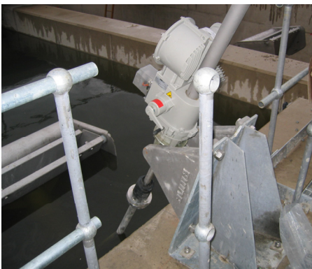
ITT Sanitaire 公司的 SBR 滌水器升级版，采用了 SIPOS 5 Flash 变频智能型电动执行机构。
