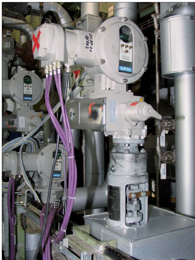
Bild 6: Großkraftwerk Mannheim: SIPOS-Antrieb auf Einspritzregelventil
