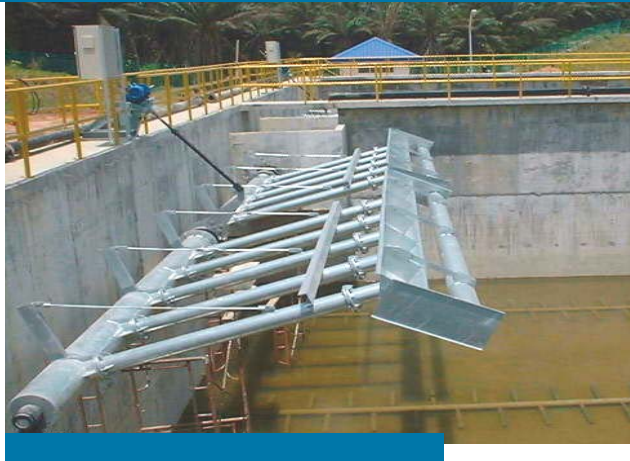
Bild 4: Positionsgenaues Steuern des Dekanterarms mittels adaptivem Stellungsregler und Leittechnik: Kläranlage in Malaysia
