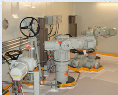
Zainstalowane napędy SIPOS AS
