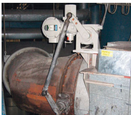
Nowy napęd na istniejącej armaturze
